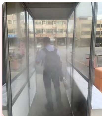
▲ 入廠消毒噴霧門
