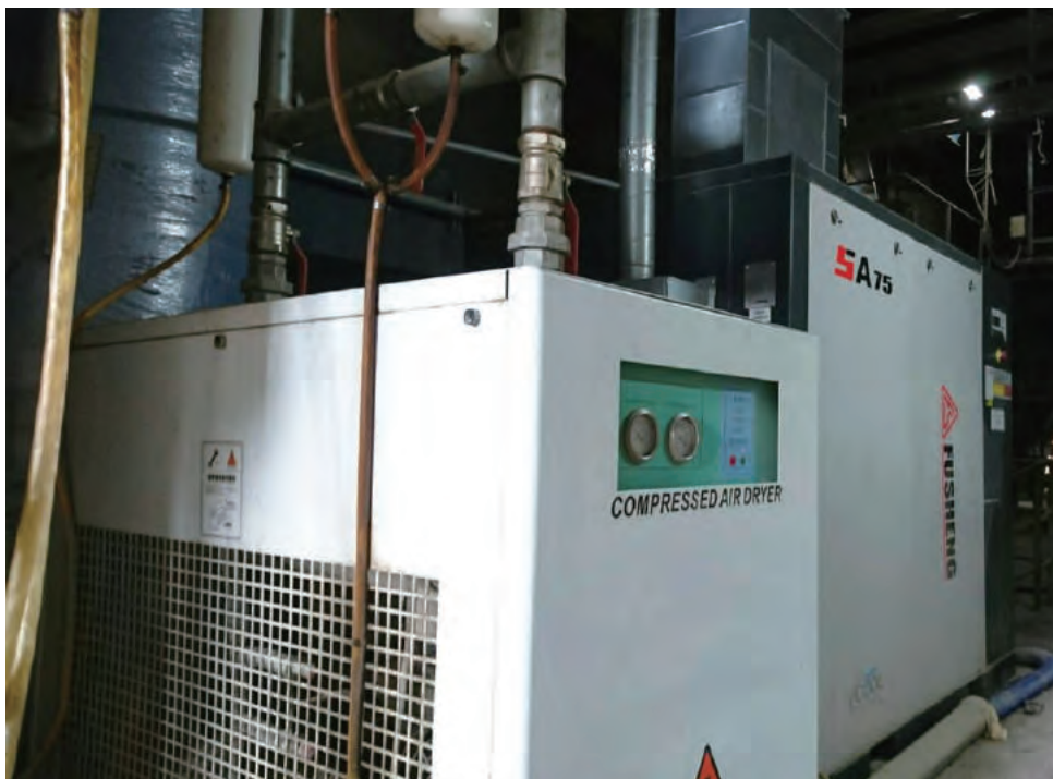
空壓機汰換為變頻空壓機
