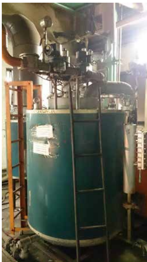
重油鍋爐轉換汰換為天然氣鍋爐
